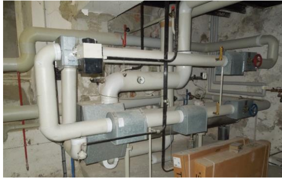
KG 420 Wärmeversorgung: Fernwärmeübergabestation Altbau
