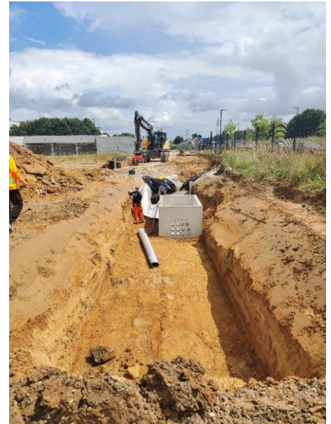
Schächte und Leerrohre unterhalt ZeIT BT2
