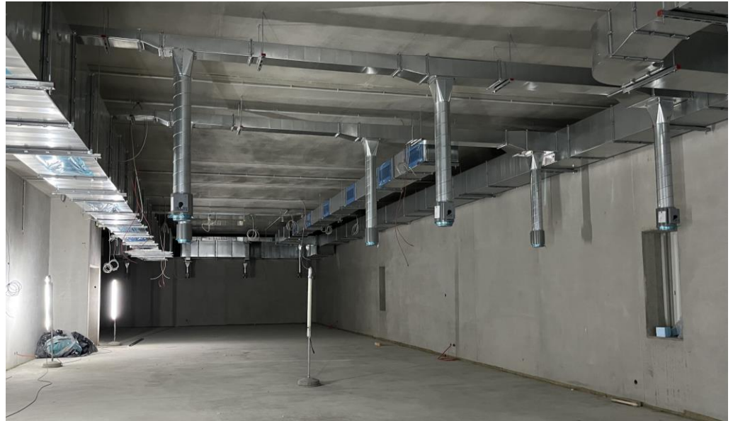
Lüftungsinstallation zum Anschluss an die Regale in einem der Bücher-Magazine
