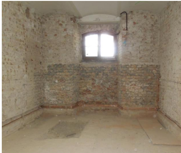
KG 420 Großschmidt-Temperieranlage zur Trocknung des Bestandsmauerwerks im Souterrain-Altbau
