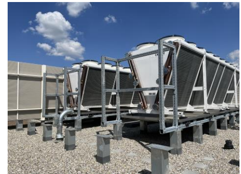
Rückkühler für die Kälteversorgung
