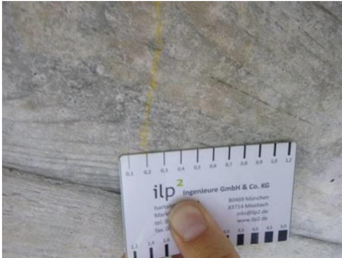
Riss mit 0,1 mm Breite an einem spannungsrissskorrosionsgefährdeten Bauwerk
