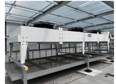
Rückkühler für die Kälteversorgung
