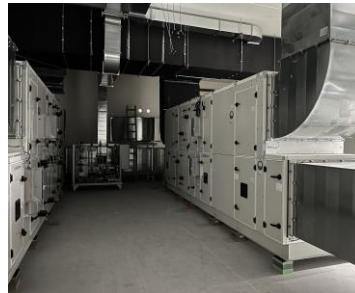
RLT-Zentrale im Untergeschoss
