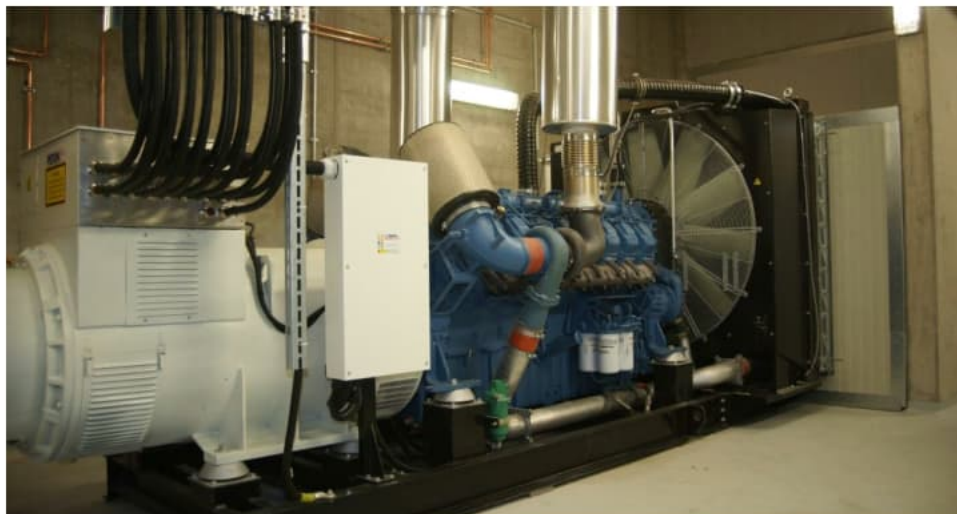
Notstromaggregat – Bei Ausfall der öffentlichen Versorgung kann die Sicherheitstechnik weiter betrieben werden.
