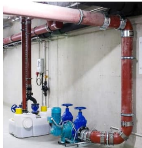
Hebeanlage m. vorgeschaltetem Häcksler
