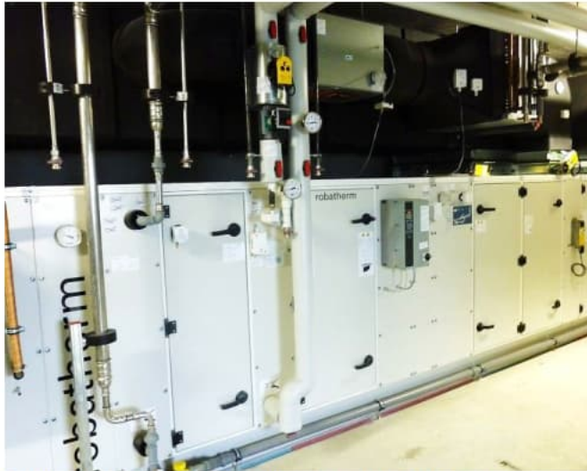
Teilklimaanlage zur Sicherstellung konstanter Raumbedingungen
