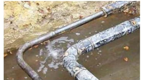
Leckage im Nahwärmenetz bei Wiederinbetriebnahme
