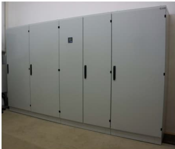
Neue Niederspannungshauptverteilung der ehem. Alfred-Delp-Kaserne
