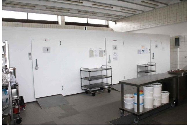
Zwei Kühl- und eine Tiefkühlzelle im Wirtschaftsgebäude
