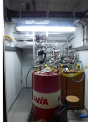
Befüllen eines Lagerbehälters aus einem 200-Liter Fass
