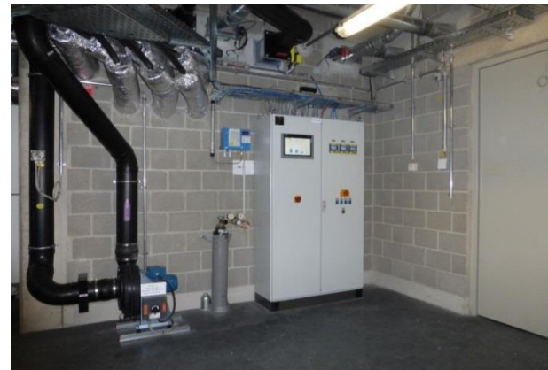
Lagerraumbelüftung, Kraftstoffleitungen, Leckkontrolle, Schaltschrank
