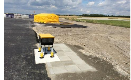
Neue PAPI's und unbeschädigte Fanganlage
