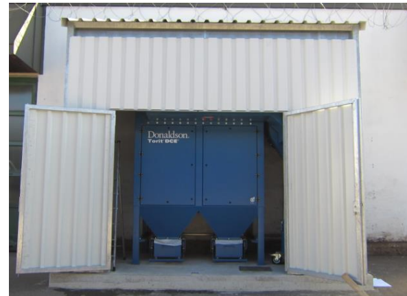
Zentrale Filtereinheit für Schweißrauch
