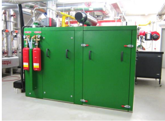
Erdgas-BHKW mit 49,5KW el. Leistung und 95kW Wärmeleistung
