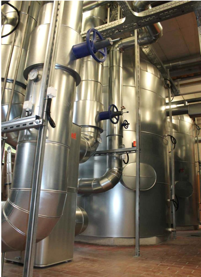
Pufferspeicheranlage mit einem Fassungsvermögen von 20.000 Litern Heizwasser zur Kompensation von Lastspitzen
