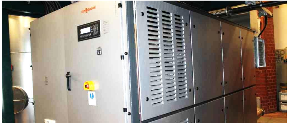
BHKW-Modul mit 238 kW elektrischer und 363 kW thermischer Leistung: Durch den zusätzlich erzeugten Strom werden ca. 85 % des Liegenschaftsstrombedarfs über das BHKW gedeckt
