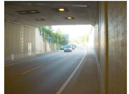
Beleuchtungsstörung wegen defekter SPS
