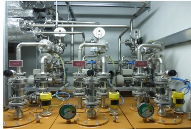
Installationen auf den Lagerbehältern
