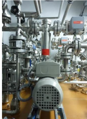
Druckregler, Magnetventile, Pumpenmotor
