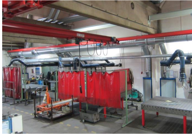
Schweißrauchabsaugung in der Schlosserei
