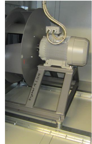
Freistromrad in RLT-Anlage
