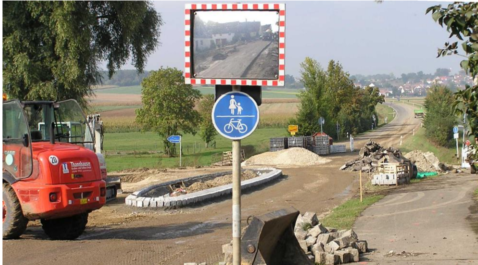
Fahrbahnleiter bei Wengenhausen
