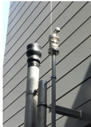
Lüftungen: Lagerraum bzw. -behälter
