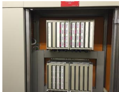
Defekte SPS im Betriebsgebäude
