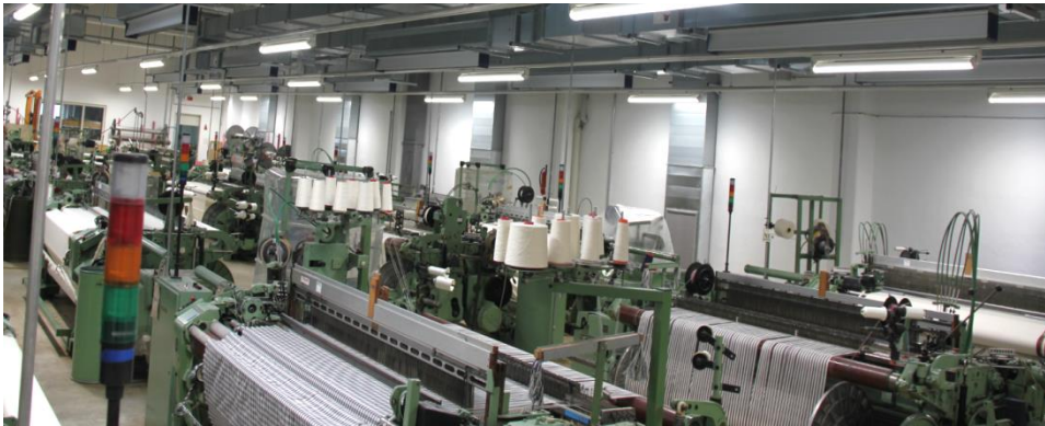
RLT-Anlage in der Weberei
