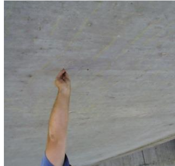
Kennzeichnung von Rissen
