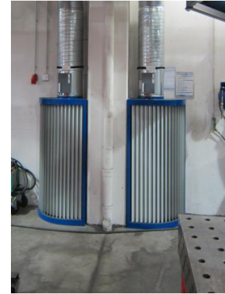
Quellluftauslass zur Luftrückführung
