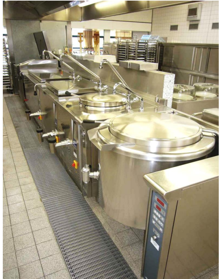
Umstellung der mit Heißwasser betriebenen Küchengeräte auf elektrischen Betrieb durch Neubeschaffung einer Bandspülmaschine sowie mehrerer Kochessel
