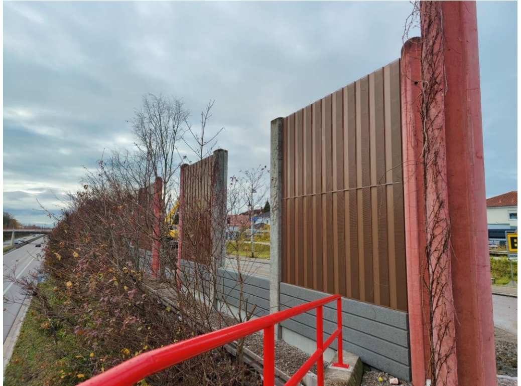
Ansicht mit neuen Wand-/Sockelelementen zwischen bestehenden Betonposten und neuem Geländer neben dem Betriebsweg.
