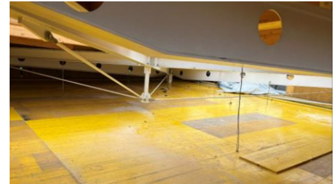
Zwischenebene im Innenbereich als Absturzsicherung
