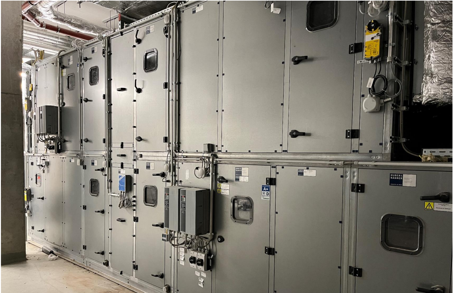
Lüftungsanlage „RLT 4“ für die Bibliothek mit 12.200 m 3 /h
