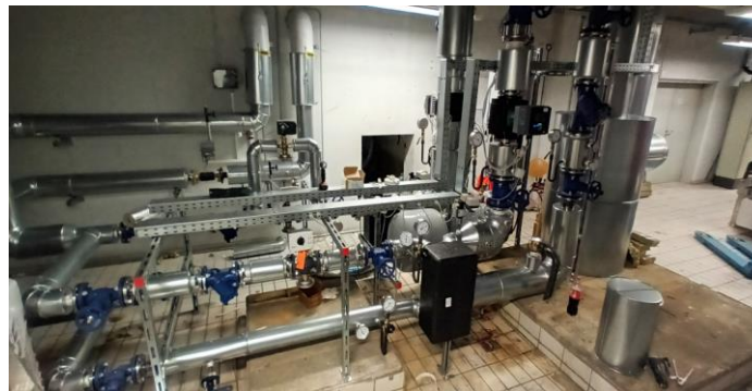
Neue Fernwärmeübergabestation mit 2 x 480 kW Übertragungsleistung
